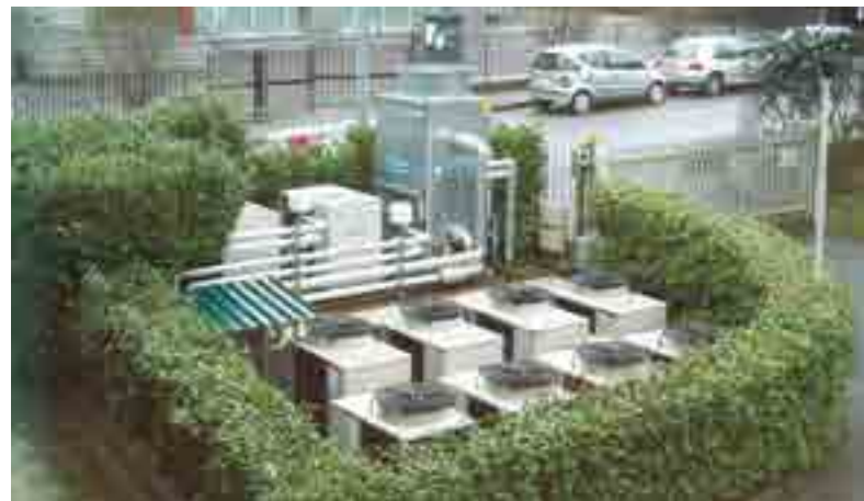
Impianti tecnologici struttura Casa Albergo
